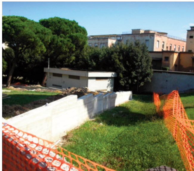
il muro abusivo al Forlanini
